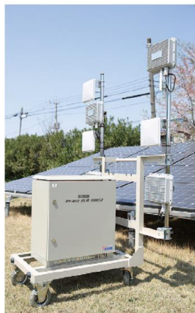
畜電池と組合せた設置
