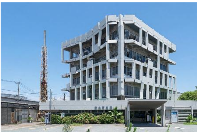
写真3 2016年4月の熊本地震で損壊した宇土市役所
