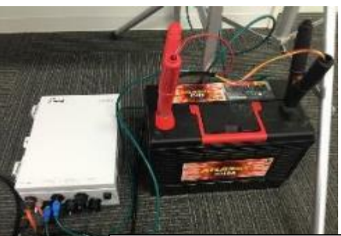
基地局装置及びバッテリー
