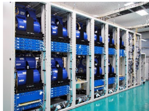
図 5：超高速光伝送実証設備
