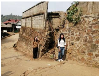
地すべりで塀が移動している
