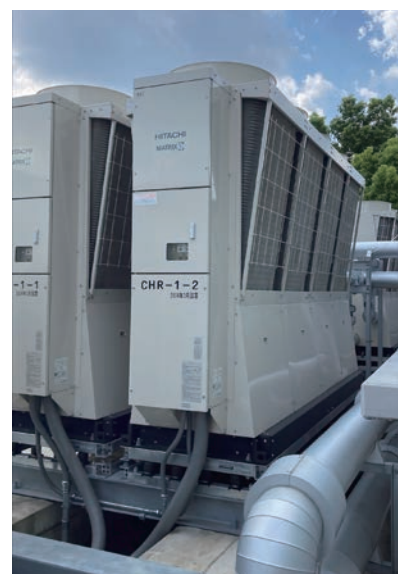
PDL の空調設備
