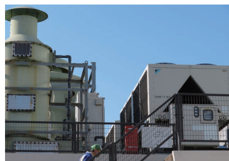
PDL の空調設備
