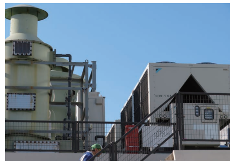
PDL の空調設備
