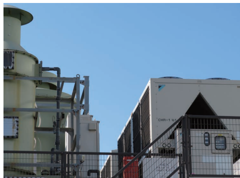
PDL の空調設備
