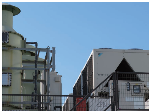
PDL の空調設備
