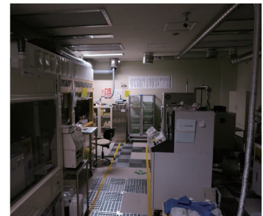
非常照明（蛍光灯）の点灯状態確認
