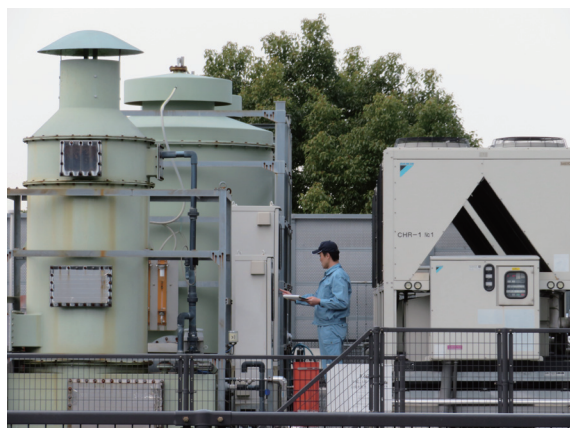
PDL の空調設備
