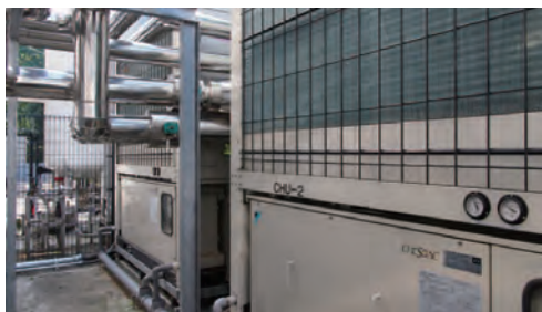
省エネ運転している ミリ波棟の冷温水同時取り出しチラー
