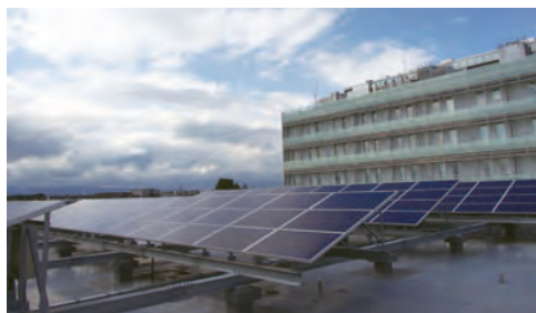
ミリ波棟屋上の太陽電池
