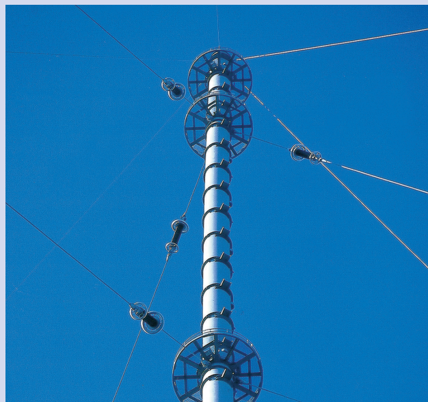
▲傘型アンテナ頂部
