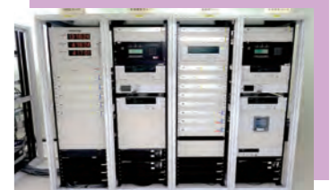
副局の計測システム
