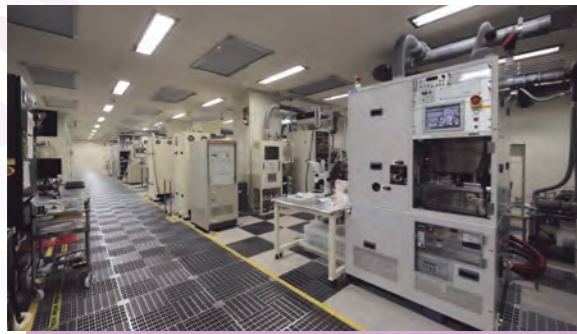
クリーンルーム内のプロセス装置
