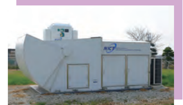
空間通信設備小型光地上局の全景
