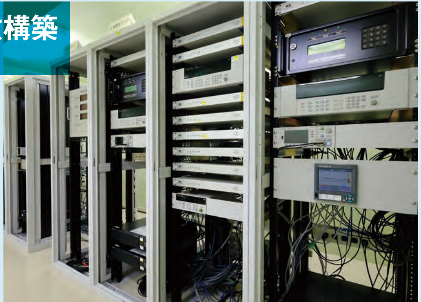
図2 日本標準時神戸副局における日本標準時計測システム
