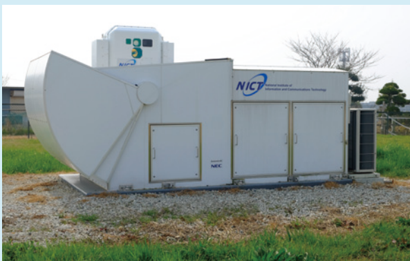
図1 光空間通信設備神戸小型地上局の全景
